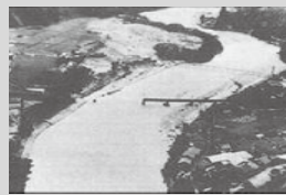
落橋したJR飯田線大千瀬鉄橋 出典：第8回天竜川流域委員会（H21.7.31）資料
